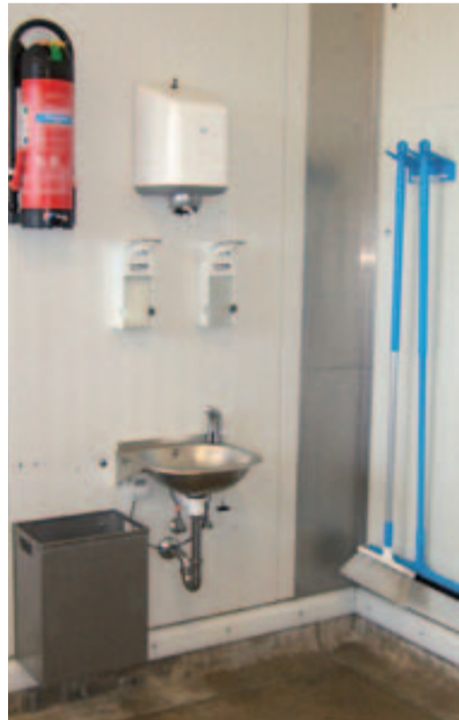
Eine vorbildliche Handwascheinrichtung mit temperiertem Wasser, Seifenspender, Desinfektionsmittel und Einmalhandtüchern.
